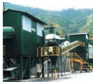
建設汚泥の固化処理プラント
