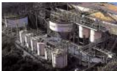
(総合排水処理装置)
