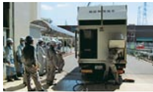
高圧発電機車の繋ぎ込み
