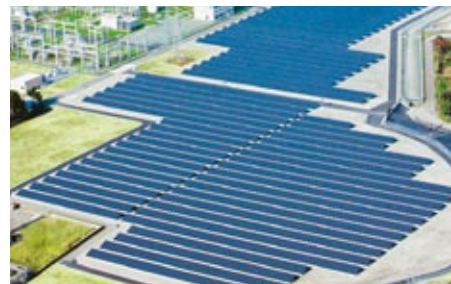
メガソーラー大牟田発電所
