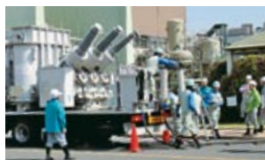
車載型移動用変圧器の接続
