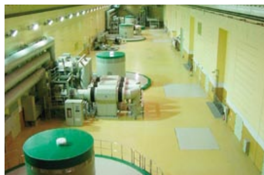
小丸川発電所(地下発電所)
