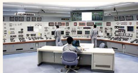
玄海原子力発電所訓練センターシミュレーター室
