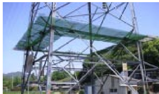
送電鉄塔の昇塔防止装置設置状況
