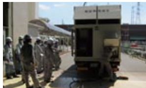
高圧発電機車の繋ぎ込み
