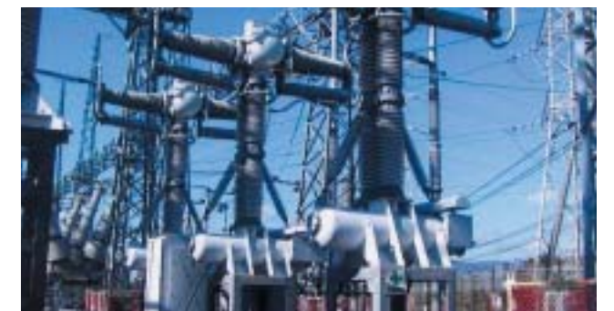
ガス絶縁開閉器
