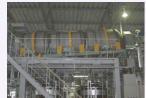
使用済蛍光管リサイクル設備
