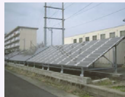
既設太陽電池パネル(8kW) 自社佐賀工場
