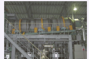
使用済蛍光管リサイクル設備
