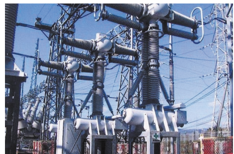
ガス絶縁開閉器
