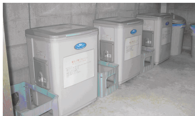
生ごみ処理機設置状況
