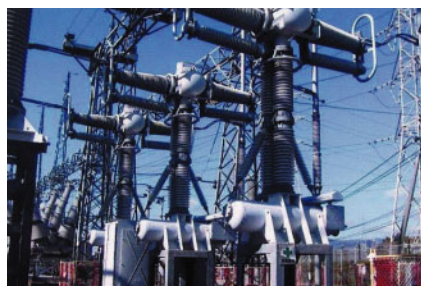
ガス絶縁開閉器
