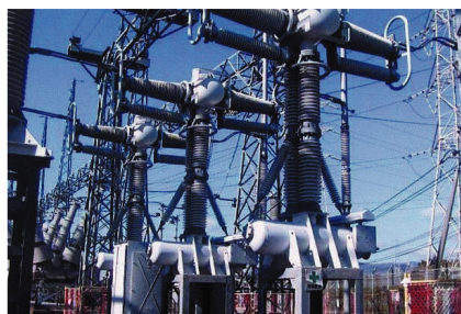
ガス絶縁開閉器
