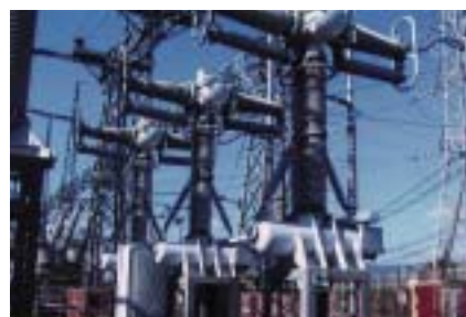
ガス絶縁開閉器
