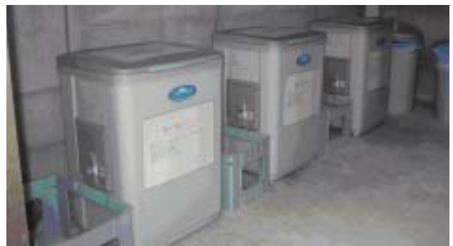
生ごみ処理機設置状況
