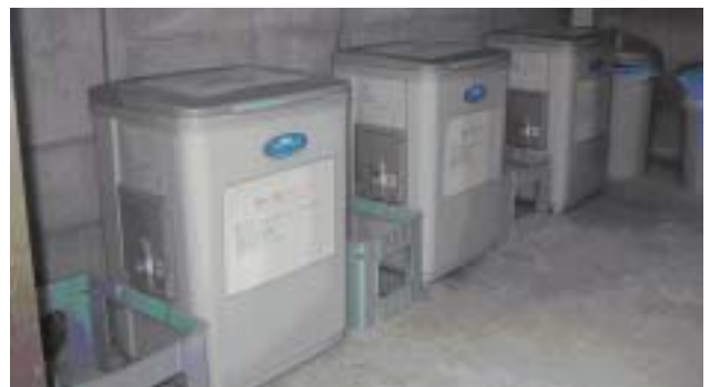
生ごみ処理機設置状況
