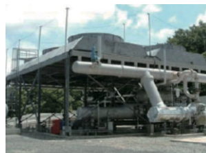
八丁原バイナリー発電所(大分県玖珠郡九重町)
