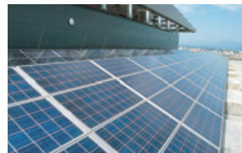
熊本支店屋上の太陽光発電設備
