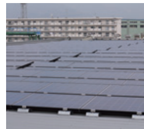
工場設置の発電設備イメージ
