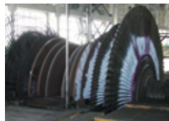
定期点検中の蒸気タービン
