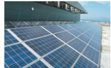
熊本支店屋上の太陽光発電設備
