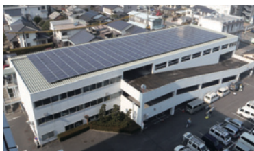
佐賀支社の太陽光発電設備(設備量:70kW)
