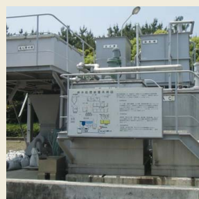
排水処理装置
