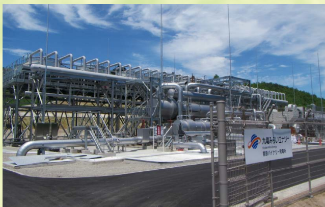
菅原バイナリー発電所
