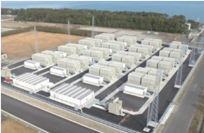
豊前蓄電池変電所全景(福岡県豊前市(豊前発電所構内))
