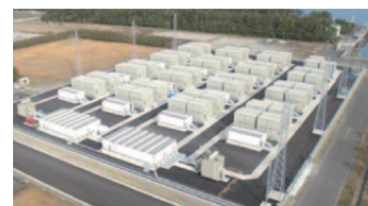
豊前蓄電池変電所 蓄電池設備
