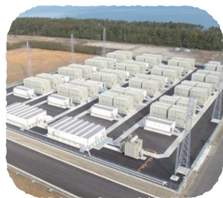
▲豊前蓄電池変電所
