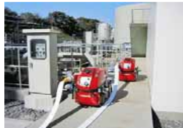
仮設ポンプ、仮設ホース
