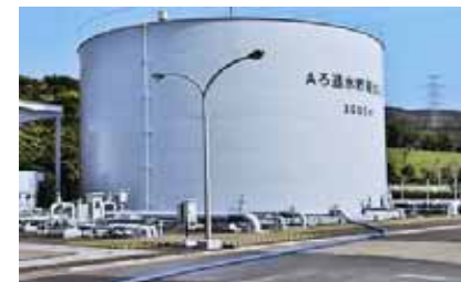
ろ過水貯蔵タンク
