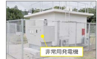
◇モニタリングステーション（敷地周辺の放射線を測る装置）の電源強化（非常用発電機設置）
