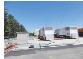
◇移動式大容量発電機（ケーブルを恒設化し、中央制御室からの遠隔起動が可能）
