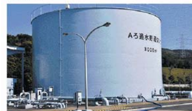
② 代替水源のタンク
