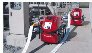
① 仮設ポンプ
