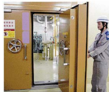
②タービン動補助給水ポンプ室の水密扉
