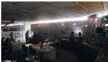
全交流電源喪失訓練
