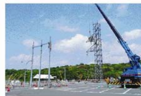
⑤ 早期電源復旧対策訓練
