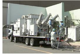
車載型移動用変圧器の接続
