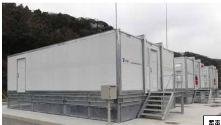
受電設備、蓄電池収納建屋写真
