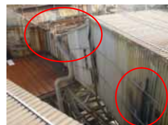
〔腐食・劣化状況〕
