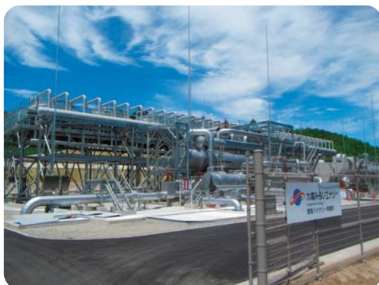
菅原バイナリー発電所
