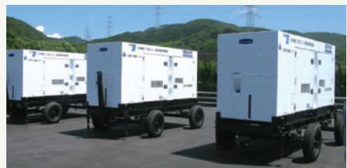
直流電源用発電機(可搬型代替電源)
