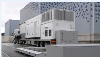
大容量空冷式発電機(交流)
