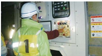
高圧発電機車による電源供給(夜間)
