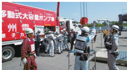
移動式大容量ポンプ車の設置
