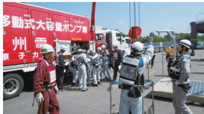
移動式大容量ポンプ車の設置
