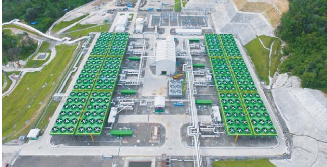
サルラ地熱発電所初号機(インドネシア スマトラ島 サルラ地区)
