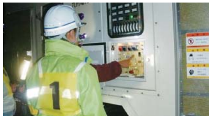
高圧発電機車による電源供給(夜間)
