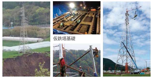
鉄塔被害状況
