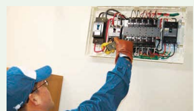
分電盤の点検
