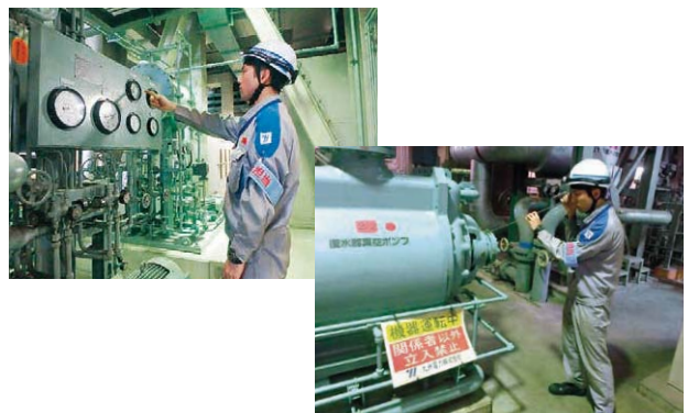
設備異常の早期発見パトロール (聴診棒による異音の確認)
