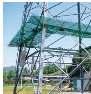
送電鉄塔の昇塔防止装置の設置
