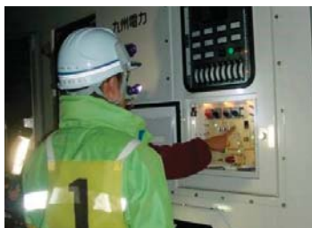
◇高圧発電機車による電源供給(夜間)
