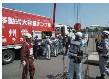
◇移動式大容量ポンプ車の設置
