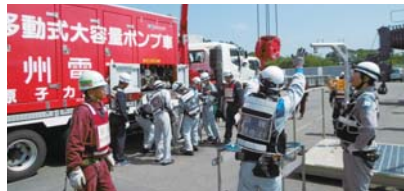
移動式大容量ポンプ車の設置
