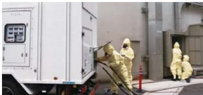
高圧発電機車の電源ケーブル接続
