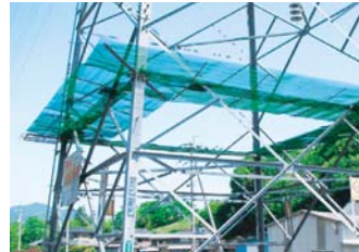
昇塔防止装置
