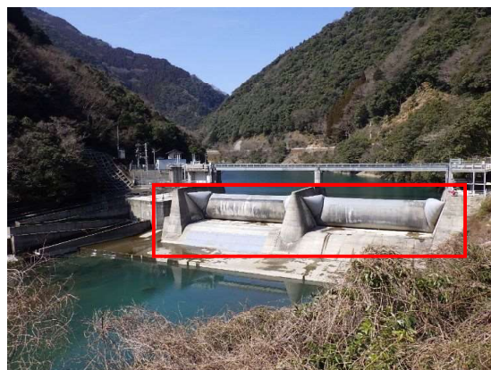
<通常時のゴム堰の様子>
