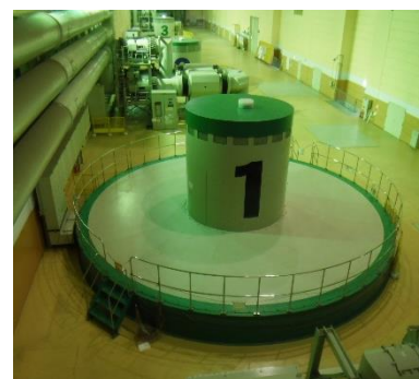
(発電機上部写真)
