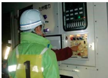
◇高圧発電機車による電源供給(夜間)
