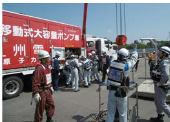
◇移動式大容量ポンプ車の設置
