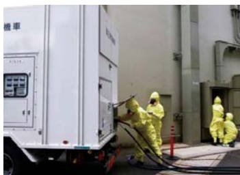
◇高圧発電機車の電源ケーブル接続
