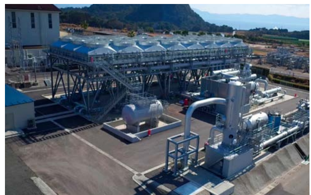
山川バイナリー発電所
