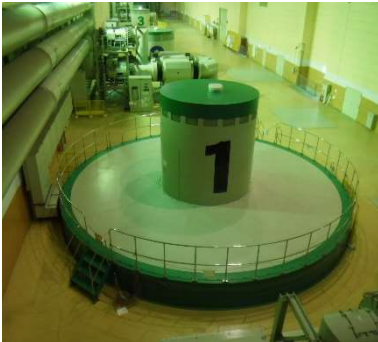
(発電機上部写真)
