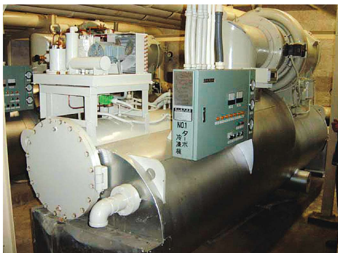
ターボ冷凍機
