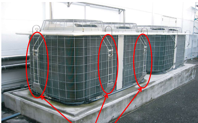
水噴霧装置の設置状況
