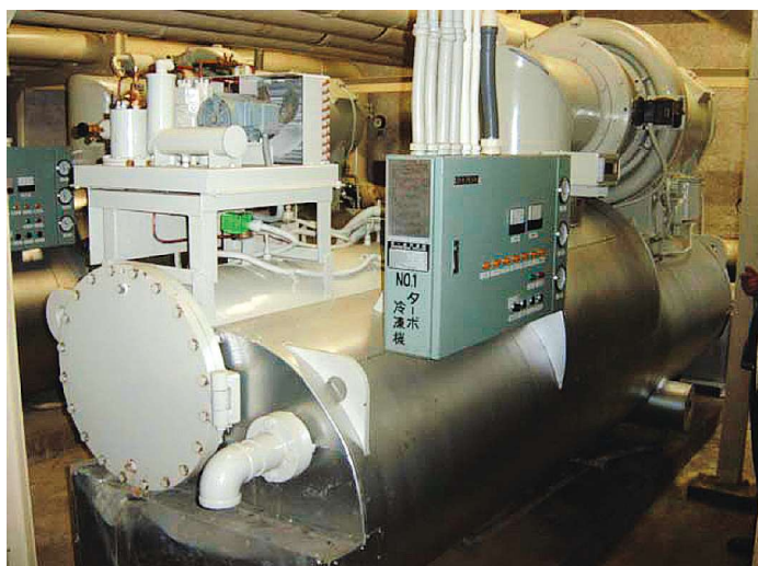
ターボ冷凍機
