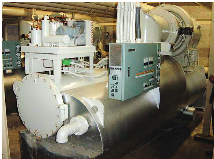
ターボ冷凍機
