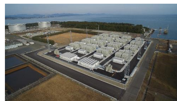
▲ 豊前蓄電池変電所
