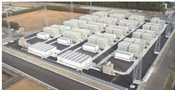
豊前蓄電池変電所 (2016年設置、出力5万kW・容量30万kWh)
